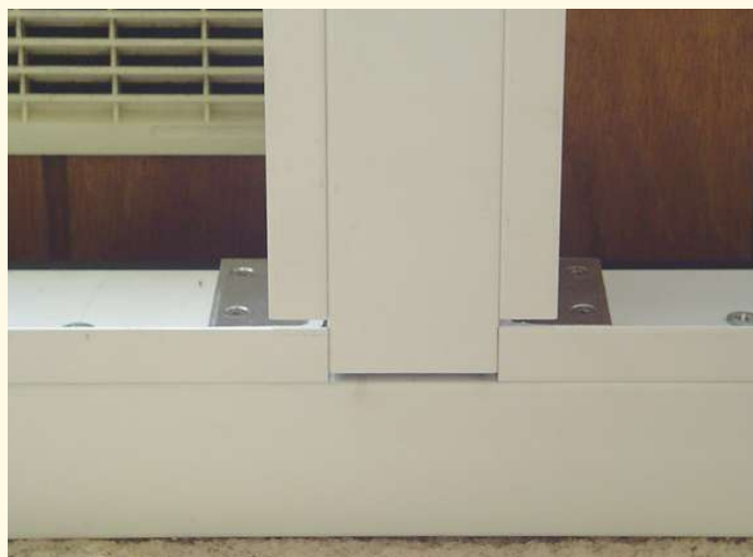
Outre le calcul correct, l'exécution d'une véranda est naturellement extrêmement importante. La photo montre une erreur par déformation des éléments lors de la pose
