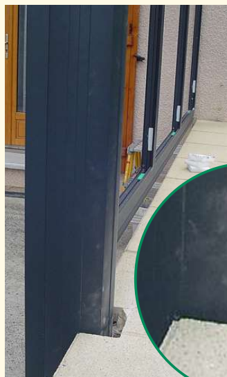
Fout door gebrekkig opmeten
